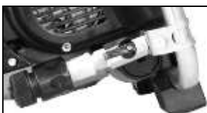
Vann forsyning åpen kran spake parallell
